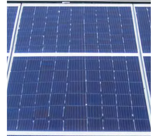
Eigene 100 kWh-starke PV-Anlage
